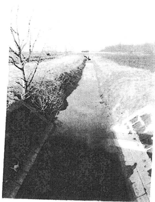
1. sz. Átvezető csatorna(4-s számú főút K-i oldala)
